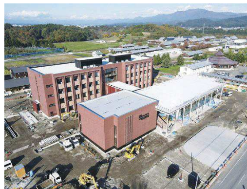
写真1 建設中の校舎(手前が一般市民も自由に利用できる交流棟、奥が教育・研究棟)
